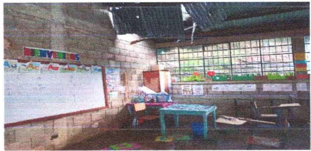
Foto 2: Se observa el daño a las láminas del techo de la escuela
